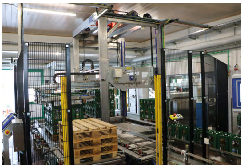
Der Palettierer transportiert zudem die Leerpaletten (v.l.) bedarfsgerecht von der Entlade- auf die Beladeseite. Ein zusätzlicher Palettentransport ist nicht erforderlich. © BMS Maschinenfabrik GmbH
