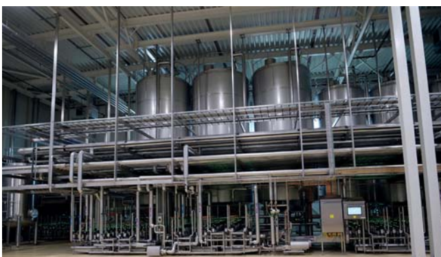
The Big Blender: klimaneutrale, elektrisch betriebene Misch- und Abfüllanlage in Rotterdam
